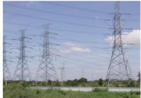
เสาไฟฟ้า
