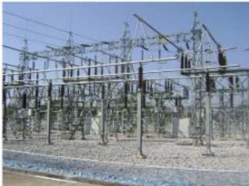
สถานไฟฟ้า
